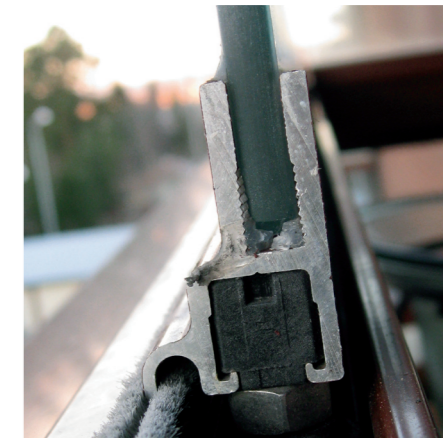
▲ Innfesting av herdet glass i et skyvevindu. Det er direkte kontakt mellom glass/glasskant og metall siden ingen pakninger er benyttet. Naboglassvindu var knust.
