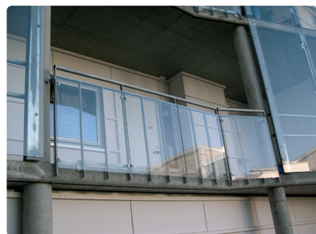
▲ Til rekkverksglass med nivåforskjell 0.5 m eller mer krever NS 3510 bruk av laminert glass.
