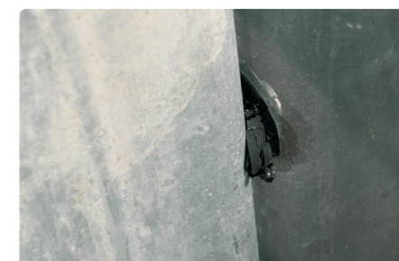
▲ Herdet glass i trappeoppgang. Pakningen i boltinnfestingen har ikke tålt klimaendringen (varme og sollys) den har blitt utsatt for i løpet av 3-4 år.
