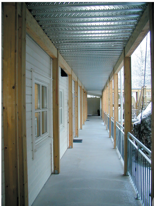
Fig. 4 c Svalgangsgolv av betong (påstøp på korrugert stålplate) Søyler og svalgangsgolv har klaring til vegg. NB! Bruk av trekledning mot svalgang forutsetter sprinkling i bygninger med mer enn to etasjer. Foto: Byggforsk
